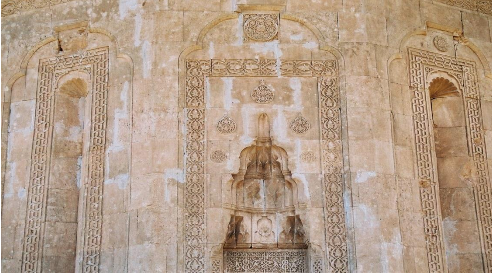
Fotoğraf 9a: Gövdede Oluşan Çatlakların Adi İnşaat Mantığıyla Onarımı
